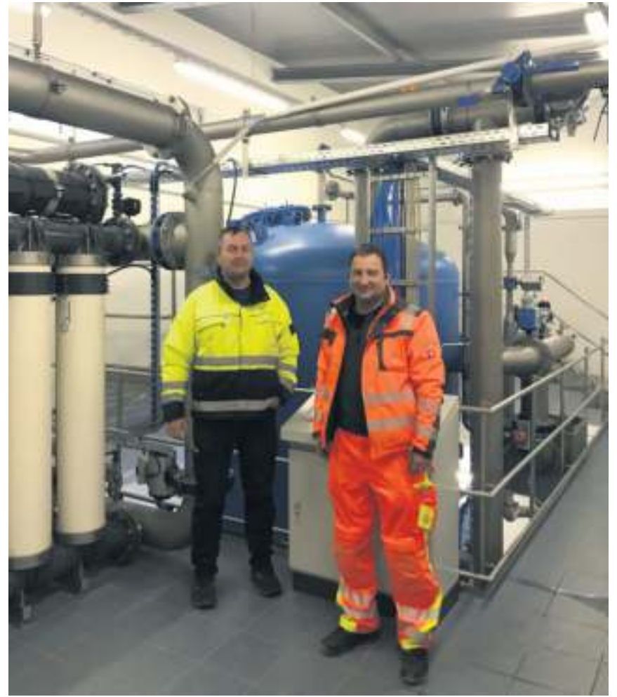
Das Bild wurde in der Trinkwasseraufbereitungsanlage Naila aufgenommen und zeigt von links: Wassermeister Klaus Gädtke den stellv. Wassermeister Jürgen Hohberger.
