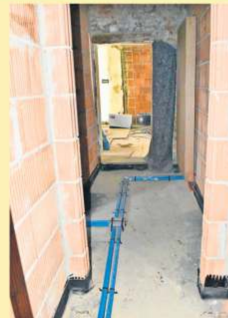
Heizungsrohre am Boden
